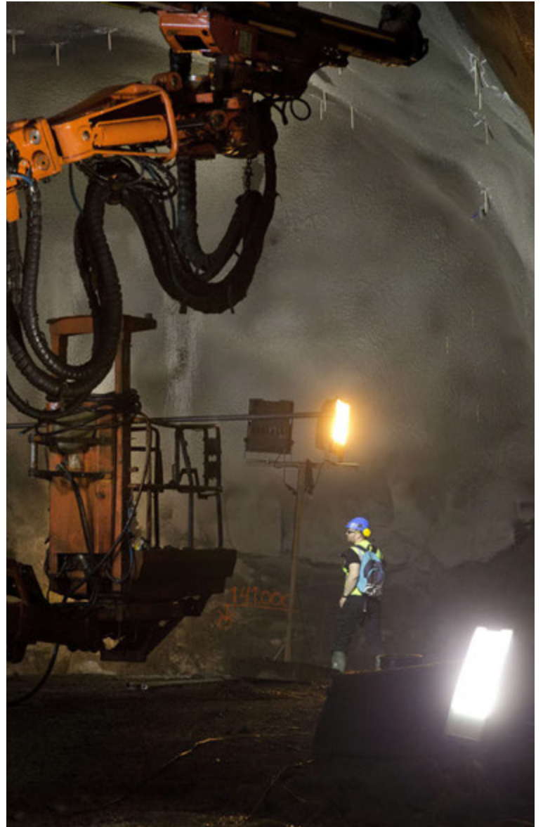
Lofthæð stöðvarhússhvelfingarinnar er nú um 10 metrar. Þegar bergstyrkingu er lokið í hvelfingunni verður grafið 30 metra niður svo koma megi stöðvarhúsinu fyrir.
