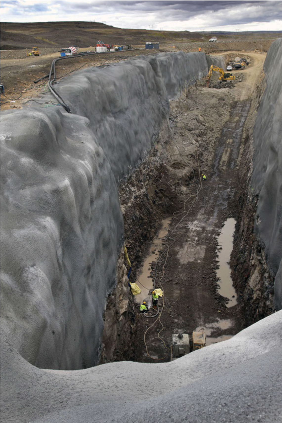
Aðrennisskurðurinn verður 370 metra langur. Hann mun veita vatni úr Bjarnalóni niður um 110 metra löng fallgöng að stöðvarhúsi inni í fjallinu.
