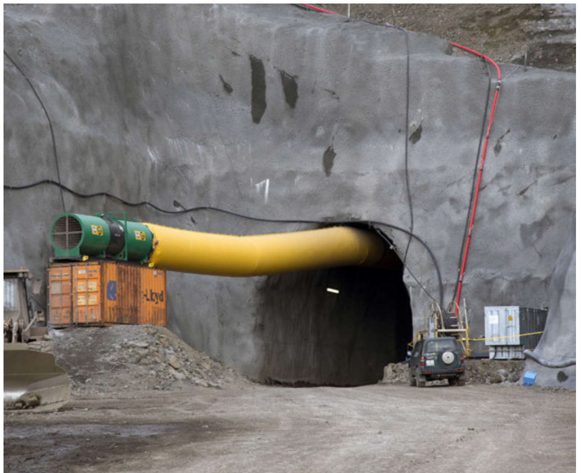
Munni aðkomuganga stöðvarhússins. Raninn sem liggur út úr göngunum er hluti af loftræstikerfi sem er notað til að tryggja loftgæði fyrir þá sem starfa inni í þeim.
